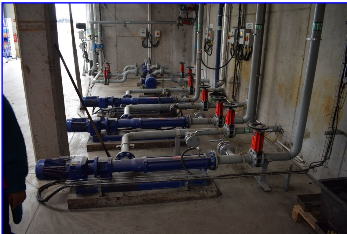
21. Stacja pomp do przepompowywania gazu z reaktora do zbiornika gazu.
