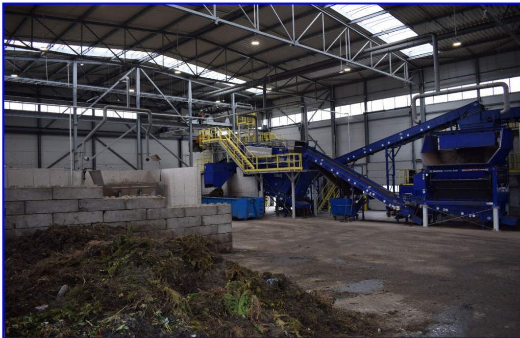
11. Tutaj zaczyna się droga potencjalnego wsadu (lewy dolny róg zdjęcia) do bioreaktora jest zasypywany do zbiornika początkowego skąd trafia na taśmociągi oczyszczania i segregacji.
