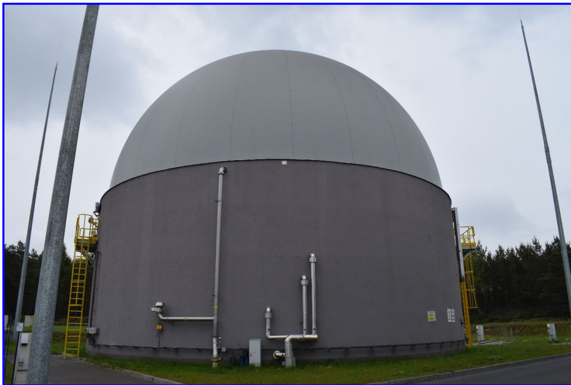
22. Zbiornik gotowego oczyszczonego gazu.
