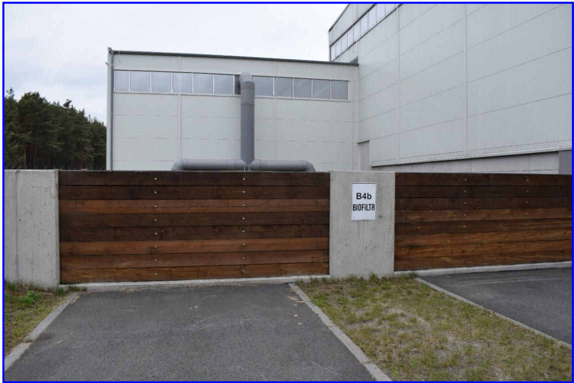
24. Drzwi – zastawki umożliwiające wymianę wkładu biofiltru.
