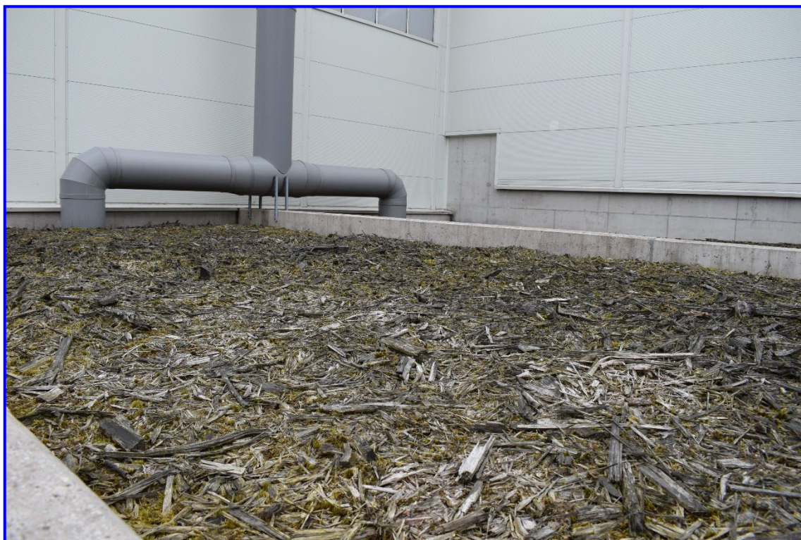
23. Rurociągi przetłaczanego powietrza z hali wraz z widokiem na wsad biofiltru.
